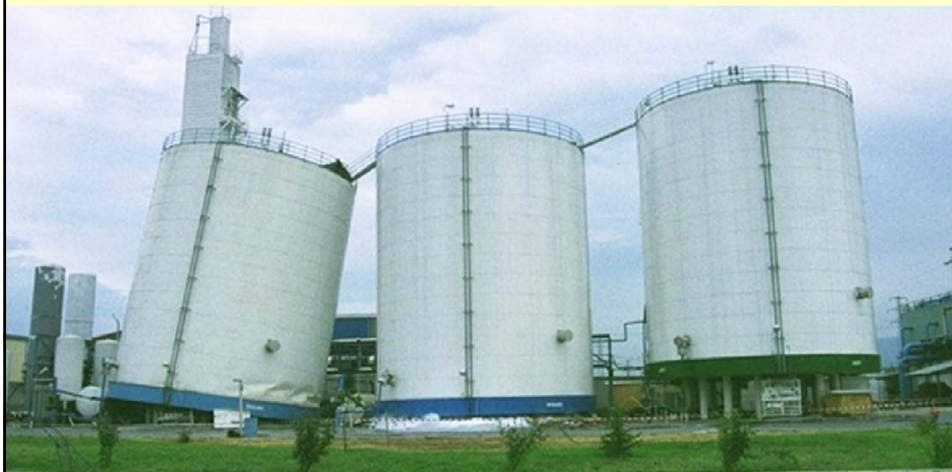
Oštećenje spremnika tekućine nakon potresa u Turskoj (1999)
