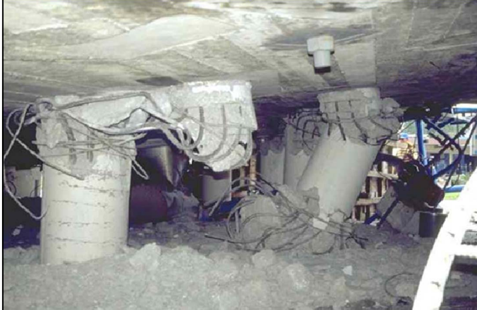
Oštećenje spremnika tekućine nakon potresa u Turskoj (1999)
